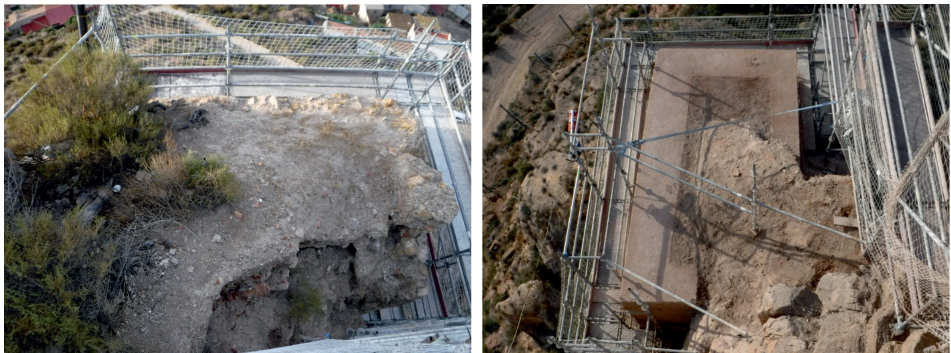
Figura 10.- Vista de la torre previamente al inicio de los trabajos arqueológicos, a la izquierda, y tras la realización del muro de protección, a la derecha.
