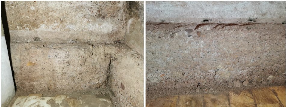
Figuras 16 y 17. Detalles de las acumulaciones terrosas, filtraciones y disgregación de material de la muralla. Fuente: Arqueonaturaleza SL.
