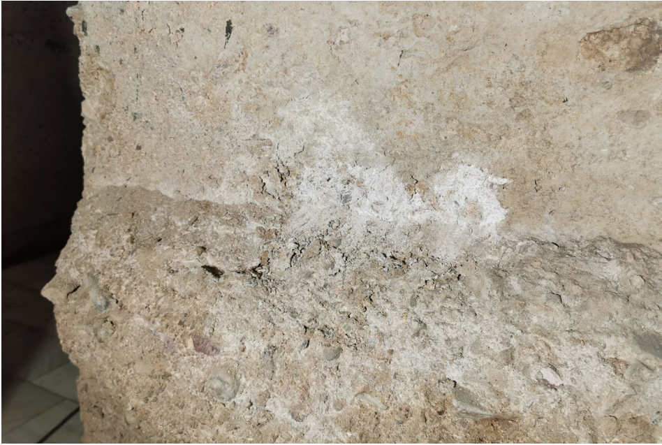
Figura 18. Detalle de las acumulaciones terrosas, existencia de eflorescencias salinas y disgregación, escamaciones y manchas de material del torreón 2. Fuente: Arqueonaturaleza SL.
