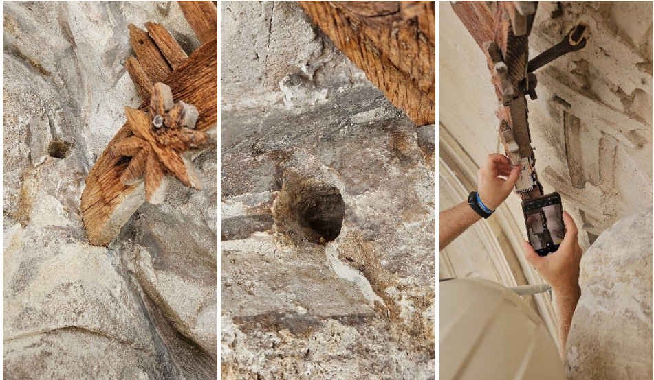
Figura 16. Las dos primeras imágenes muestran los agujeros localizados junto al arranque inicial de la corona. La última se corresponde con los trabajos de toma de muestras.
